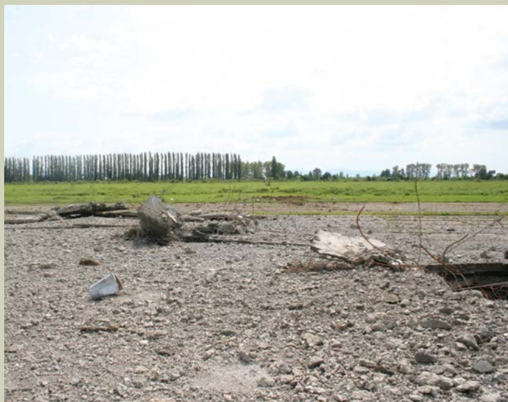
Zerstörtes Rollfeld in Senaki.
