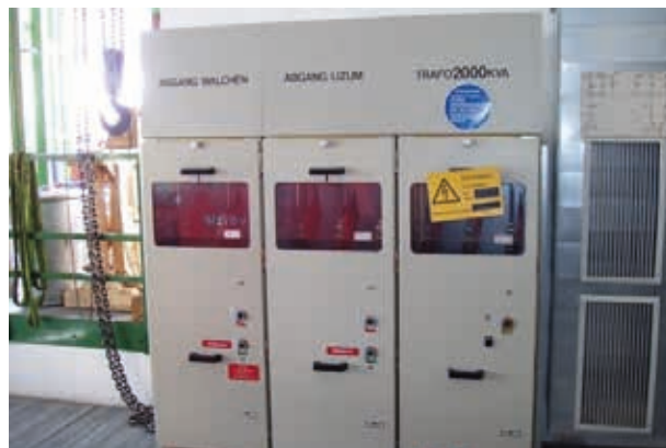
Abbildung 15: Kraftwerk Melang Hochspannungsschaltanlage Quelle: © Österreichisches Bundesheer
