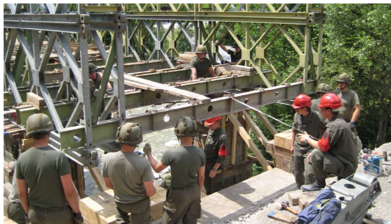
Das Anheben der Bailey-Brücke war ein sehr schwieriger und zeitraubender Teil beim Abbau in der Scheffau.
