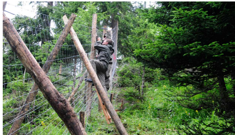
Nicht immer konnten Pfähle gerammt werden, dann behalf man sich mit Stützen oder Spreizen.
