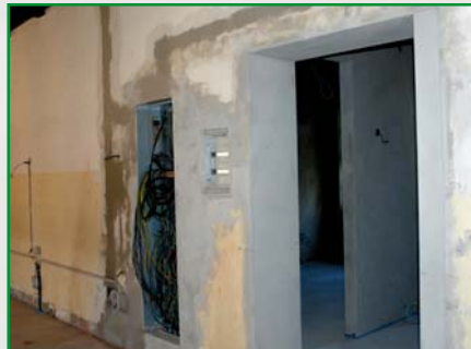
Neuer Stromverteiler und Kücheneingang
