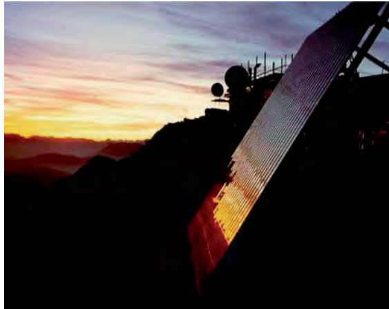
Abbildung 50: Photovoltaikanlage / Netzfunkstelle am Dachstein, ca. 2.900m
