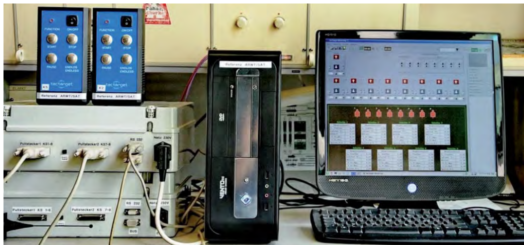
Abbildung 64: Typische Rechnersteuerung für Kurzdistanzanlagen
