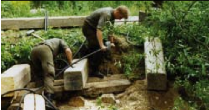
In einer Woche errichteten die Pioniere aus Mautern die Behelfsbrücke über den Reichaubach.
